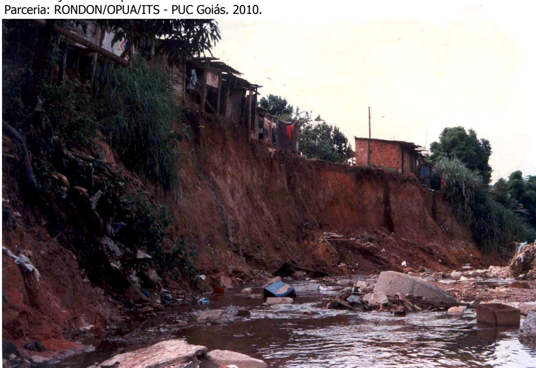
Foto 2.9: Ocupação de Área de Preservação Permanente no Setor Pedro Ludovico, 1998. Fotógrafo: João Roberto. Fonte: Arquivo da Secretaria Municipal de Habitação.
